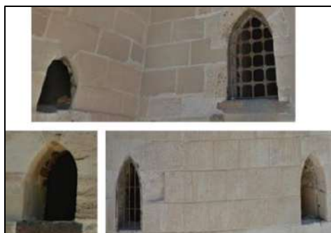
شكل رقم (٣) يوضح جانب من الشبابيك الحديدية المفقودة لقلعة قايتباي
