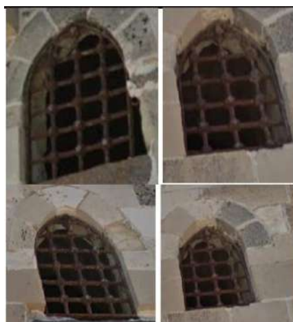
شكل رقم (٤) يوضح طبيعة ومظاهر التآكل في الشبابيك الحديدية
