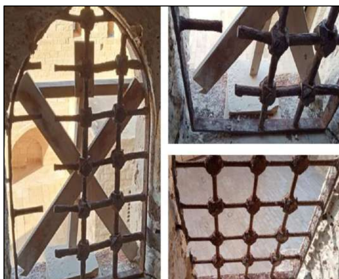
شكل رقم (١١) يوضح تآكل وصدأ وتقو وكسور في بعض الشبابيك الحديدية ٢٠٢٣
