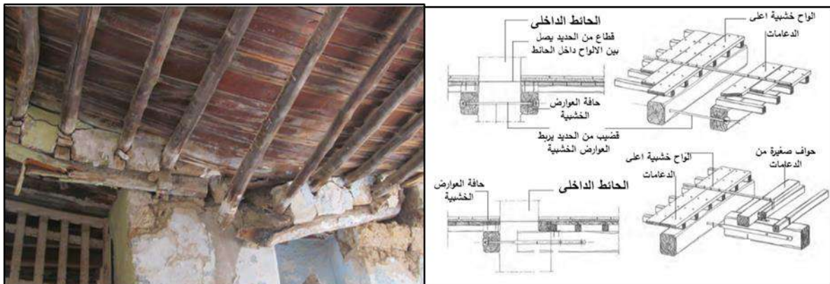
الشكل ١٤. يوضح سطح مبنى قديم بجدة من الخشب متضرر بشدة تحطمت منه عدة أجزاء و انزلقت بعض العوارض الأولية من دعامة البناء، تم معالجة ذلك باستخدام خشب مستدام يعمل على الاتصال بين الغرف المتجاورة بإطار عمودي. مثبت بواسطة عوارض متناقضة.
