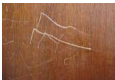
صورة(28)- توضح خدوش بألحادة حادة علي الخشب
